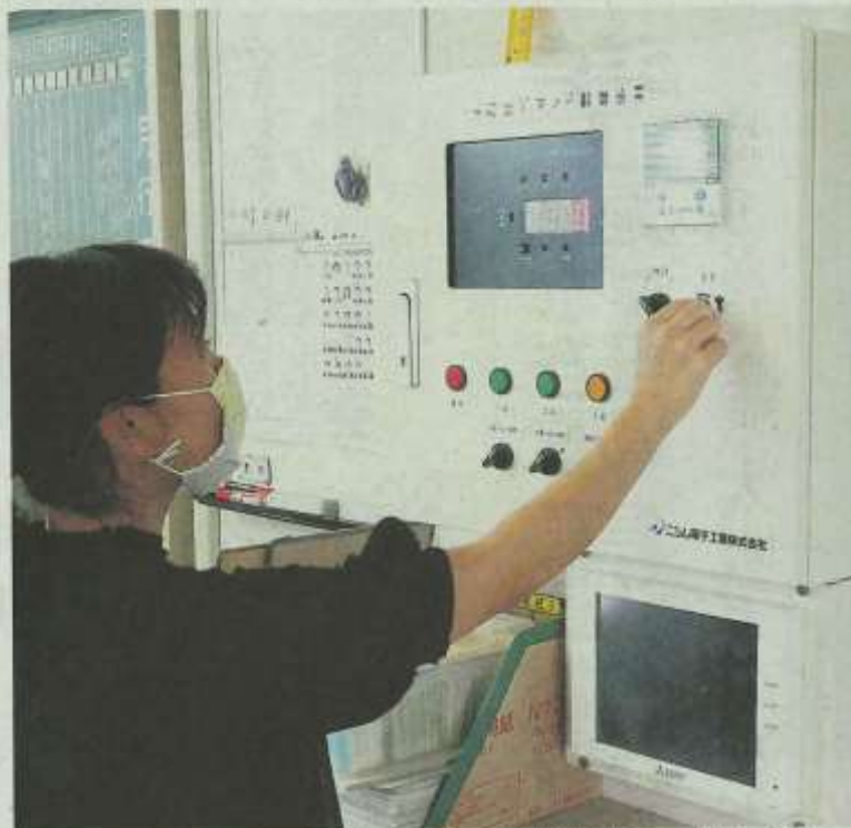
事務室に設置された制御装置。電気料金削減に加え、職員の作業も軽減されるという—神埼市の神埼清明高校
